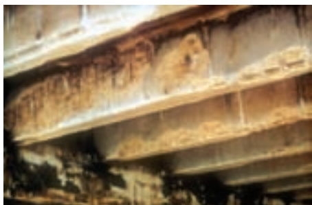
Rys. 2.5. Przykład elementów betonowych po pożarze wskazujących na odpryski. (Dzięki uprzejmości DBV, Niemcy)
