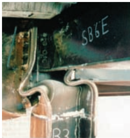
Rys. 6.1. Poważnie zdeformowana stalowa głowica stupa po pożarze (Dzięki uprzejmości Building Research Establishment, Wlk. Brytania)
