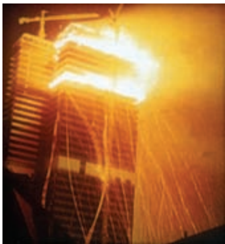
Rys. 2.4. Pożar budynku we Frankfurcie (Dzięki uprzejmości DBV, Niemcy)
